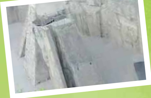
Die über 30 Jahre alte Beton-Freianlage
